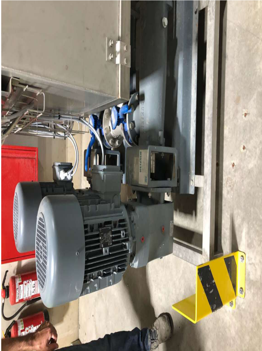
Abbildung 33: Dosiereinheit mit Netzsch-Pumpen
