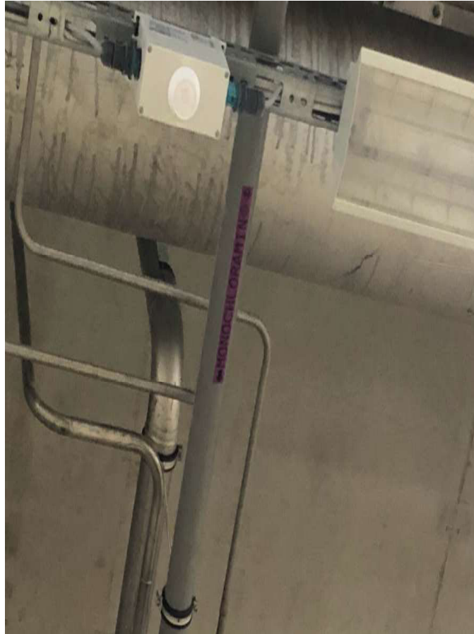
Abbildung 16: Monochloramin-Leitung in einem Rohr-im-Rohr-System in allen Bereichen, in denen Personenverkehr herrscht
