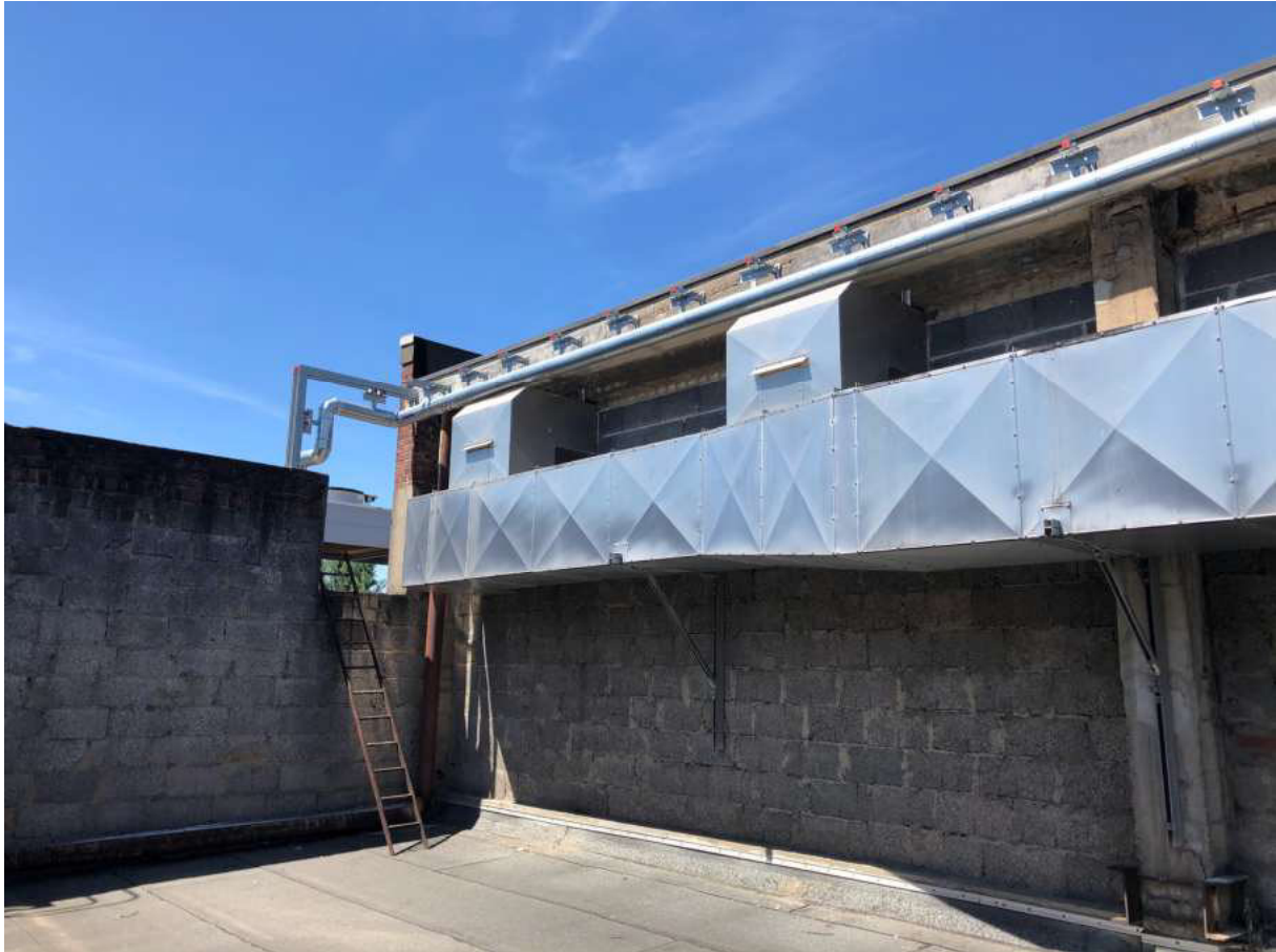
Abbildung 25: Doppelrohr im Außenbereich mit Isolierung und Rohrheizung, Zwischenraum Leckage überwacht
