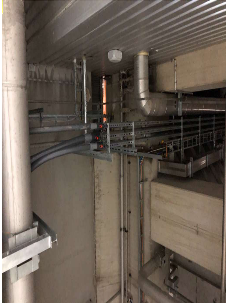
Abbildung 19: Doppelwandige Rohrleitungen mit Schaugläsern
