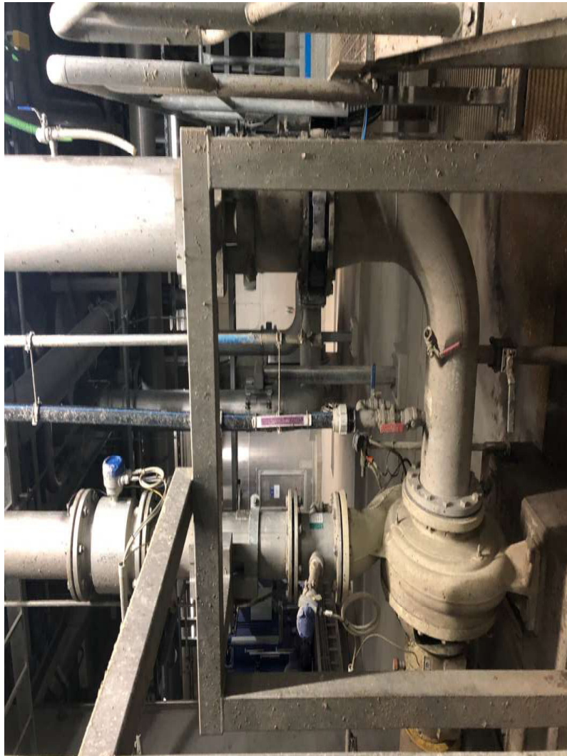
Abbildung 17: Dosierstelle für das Monochloramin mit Rückschlagventil
