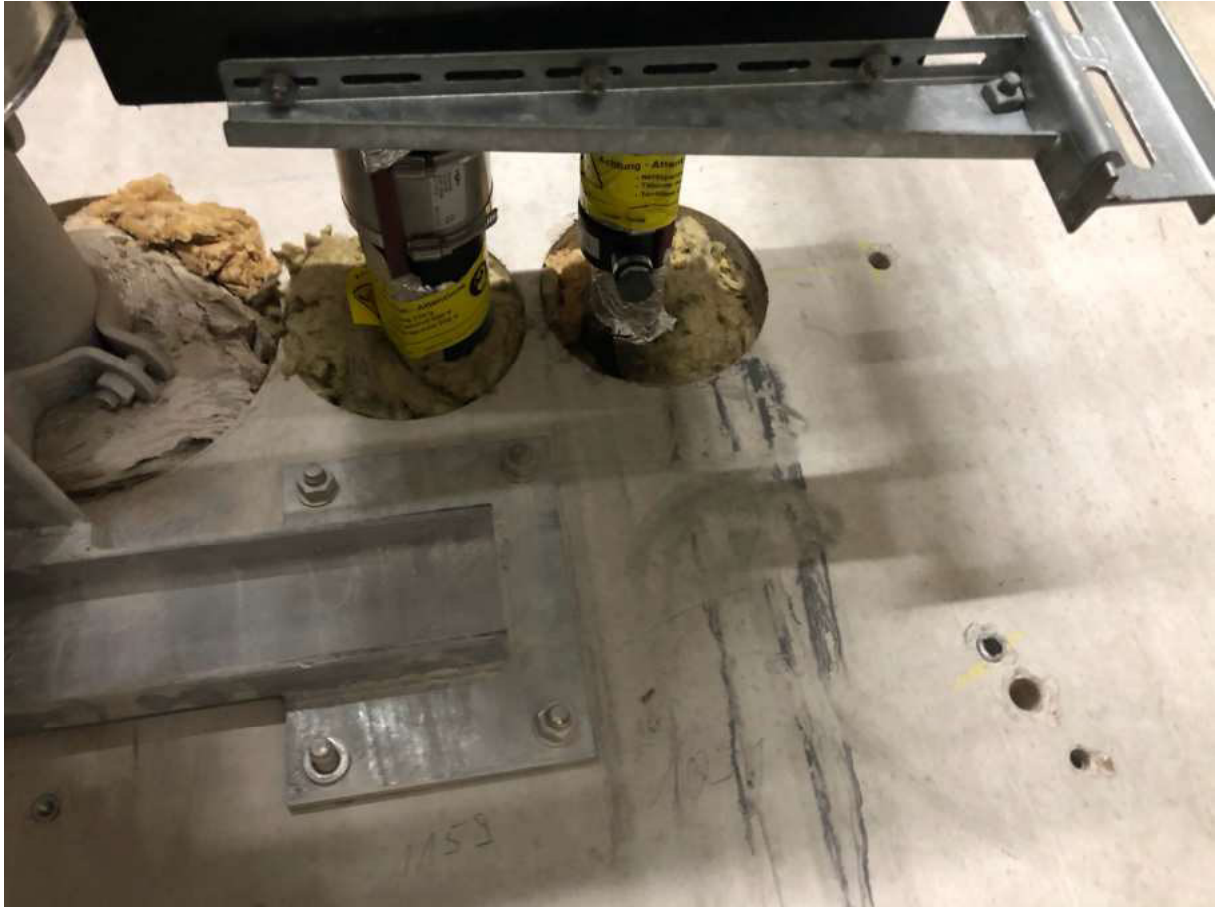
Abbildung 22: Heizung der Rohrleitung
