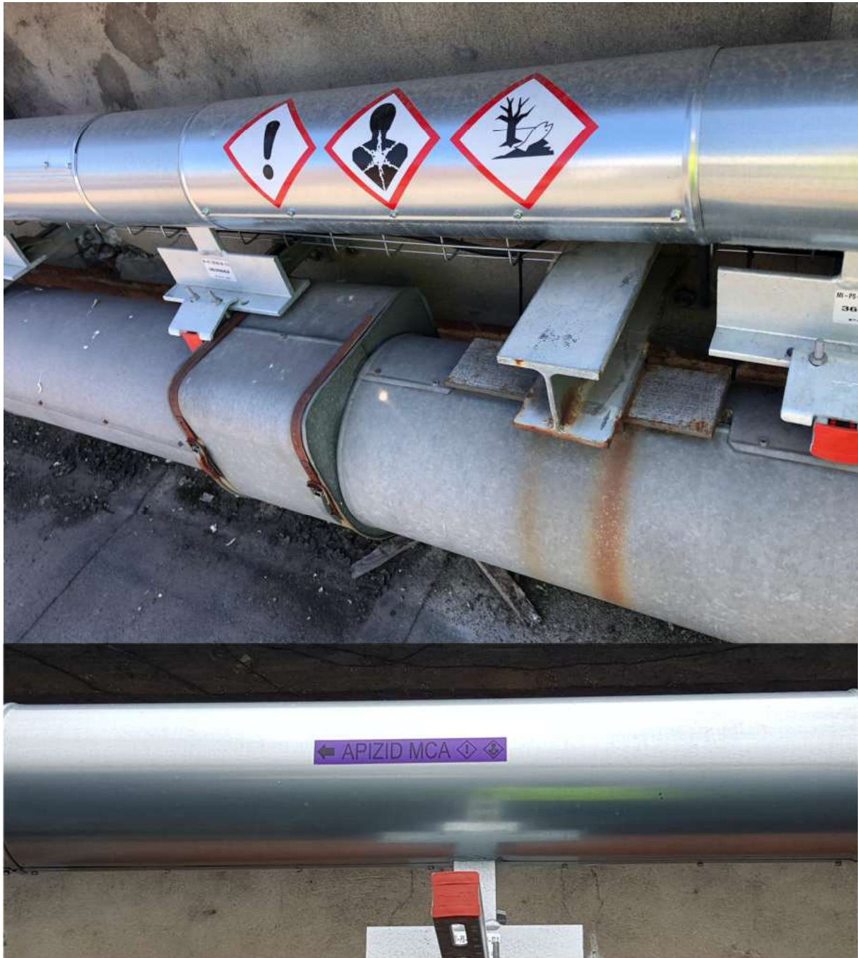
Abbildung 26: Kennzeichnung der Rohrleitungen im Außenbereich
