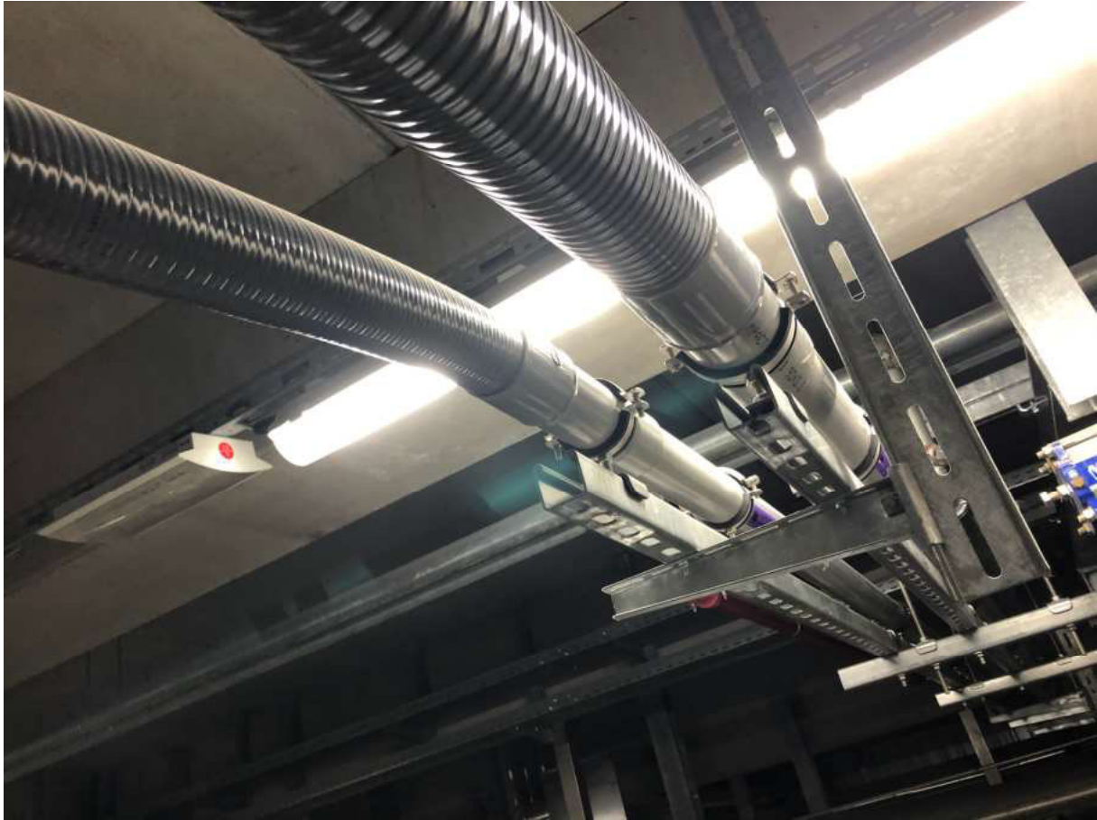
Abbildung 23: Rohrleitungen in Schutzrohr (Schutz vor mechanischen, chemischen sowie physikalischen Einflüssen, Spritzschutz im Falle einer Leckage)
