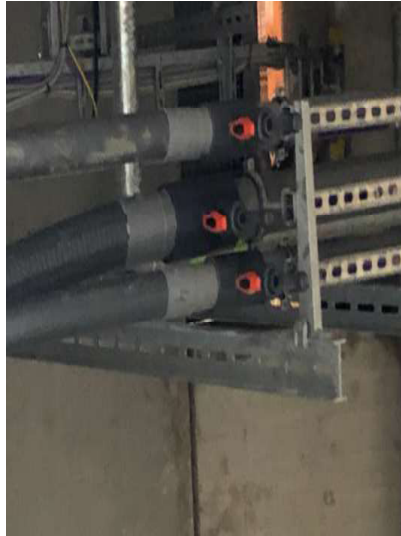
Abbildung 20: Detailansicht Doppelwandige Rohrleitungen
