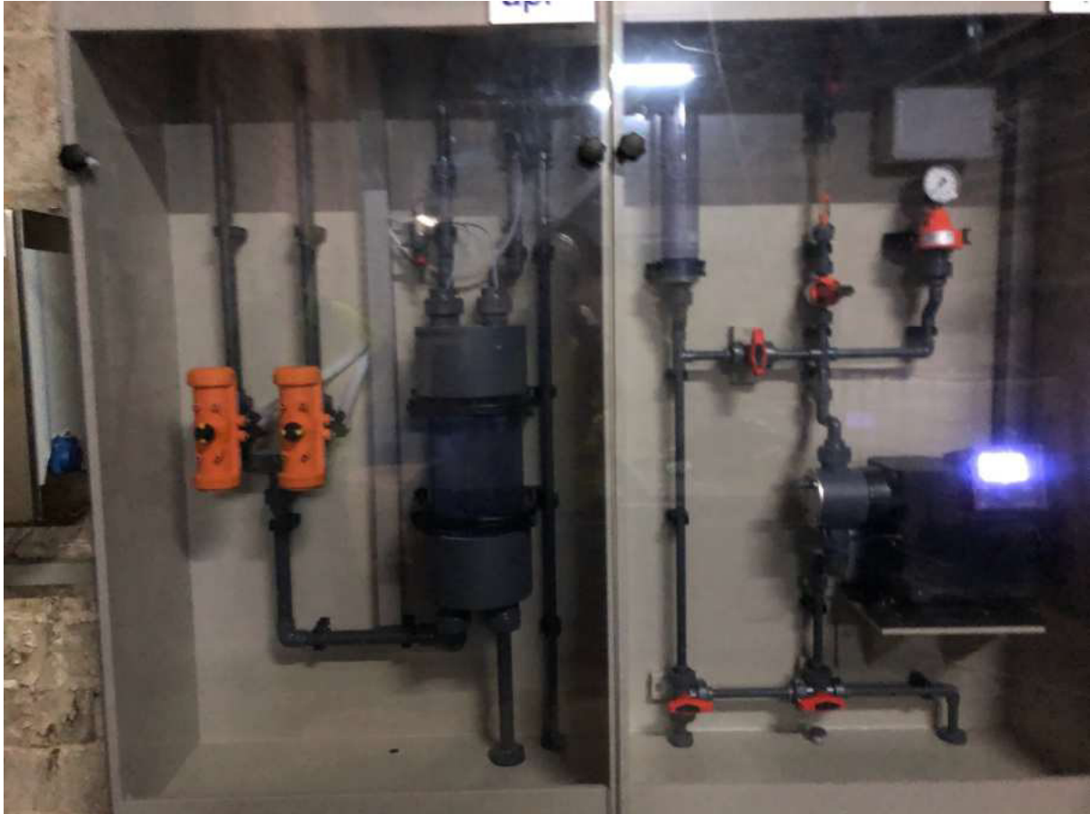
Abbildung 30: Dosieranlage für Apinox 24 bestehend aus Apiswitch und einer Dosierpumpe
