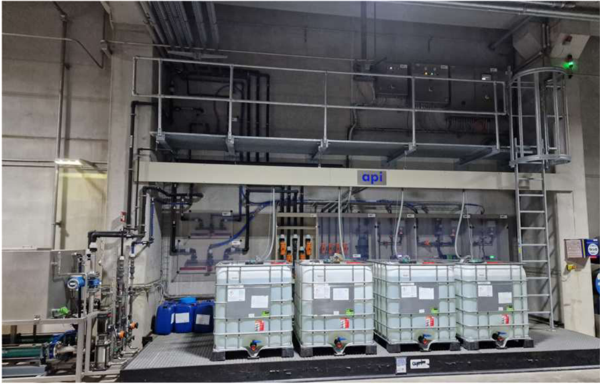
Abbildung 2: Dosiereinheit (Ammoniumchlorid, Natriumhypochlorit) mit 2,5 m 3 Auffangwanne (Details siehe Teilleiste), diese Wanne wurde mit einer Einzelprüfung der TPO versehen, siehe unten
