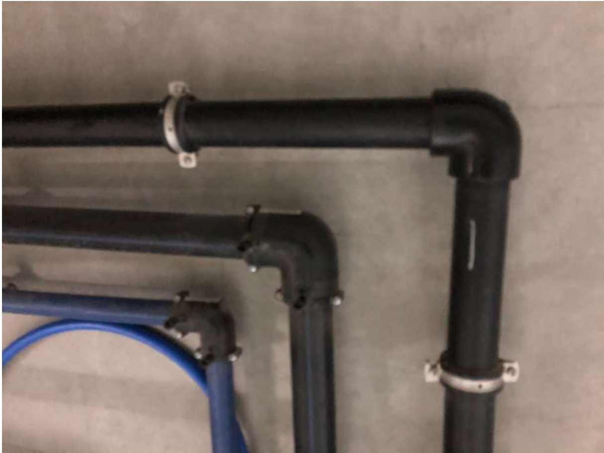
Abbildung 15: Rohrbögen teils mit Elektromuffen im Wasserbereich und Muffen mit Heizedornsweißverfahren für Chemie
