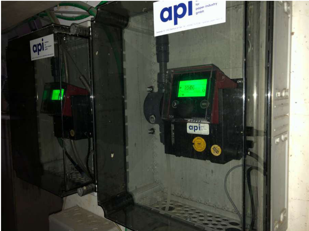
Abbildung 29: Dosierpumpen im Schutzkasten
