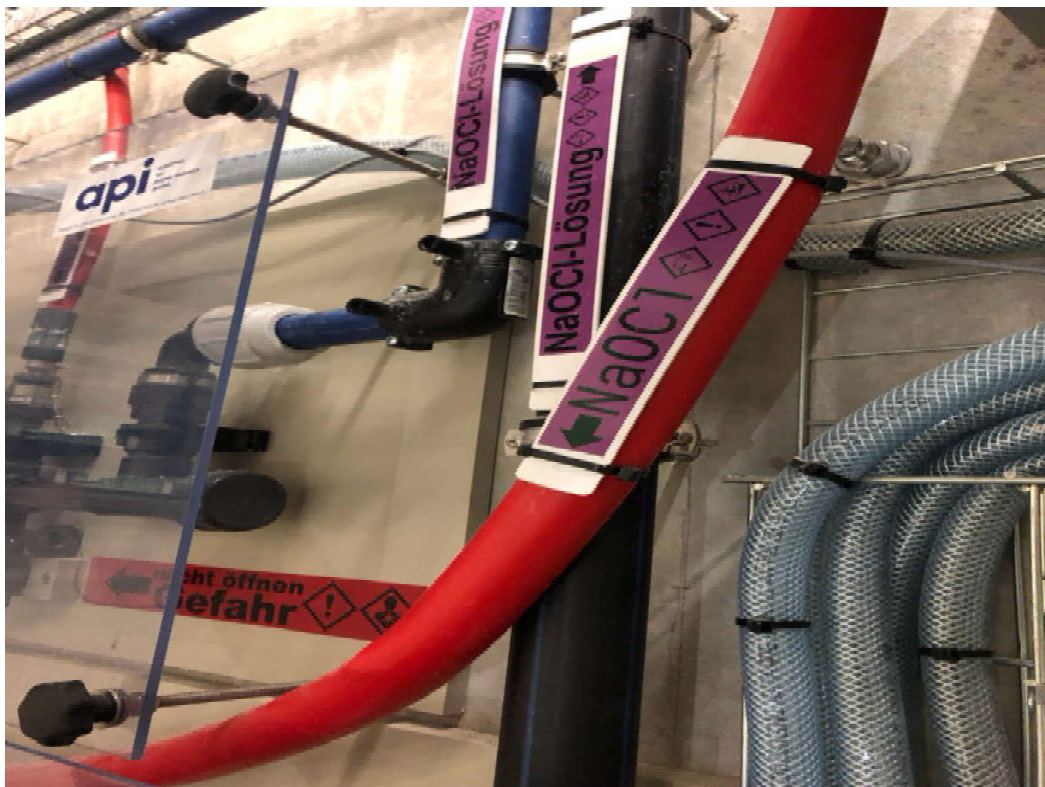
Abbildung 6: Rohrleitungen und Kennzeichnungen nach DIN2403
