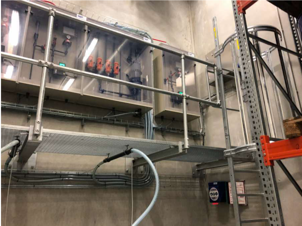
Abbildung 4: Wartungsbühne mit Dosierein-pumpen für die Frischwasserbehandlung Links/ Rechts, in der Mitte Apiswitch Anlage
